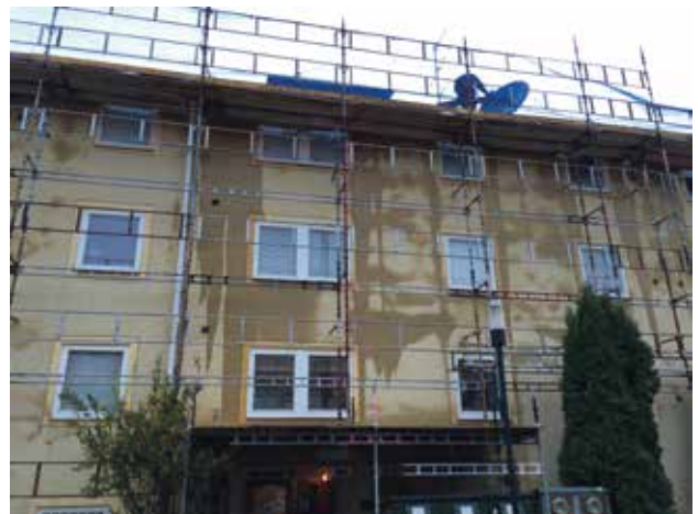
Dålig skyddstäckning vid takreovering kan medföra nedfuktad fasad och kostsamma skador som följd.
