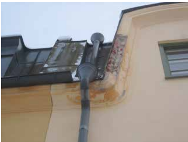
Skador i profilerad putslist orsakat av tillbakadrivande vatten. Taksprång vid liknande takformer ska utföras med lodrät droppkant alternativt med ståndfals och avledare.
