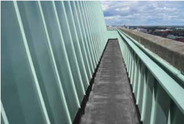
Gesimsrännor och rännndalar med låglutande botten har sammanfattningsvis mycket problem med läckage från otäta plåtfalsar. Gesimsrännor och dylikt bör utföras med tätskikt alternativt med förstärkt underlagstäckning om falsad plåträna ska utföras.
