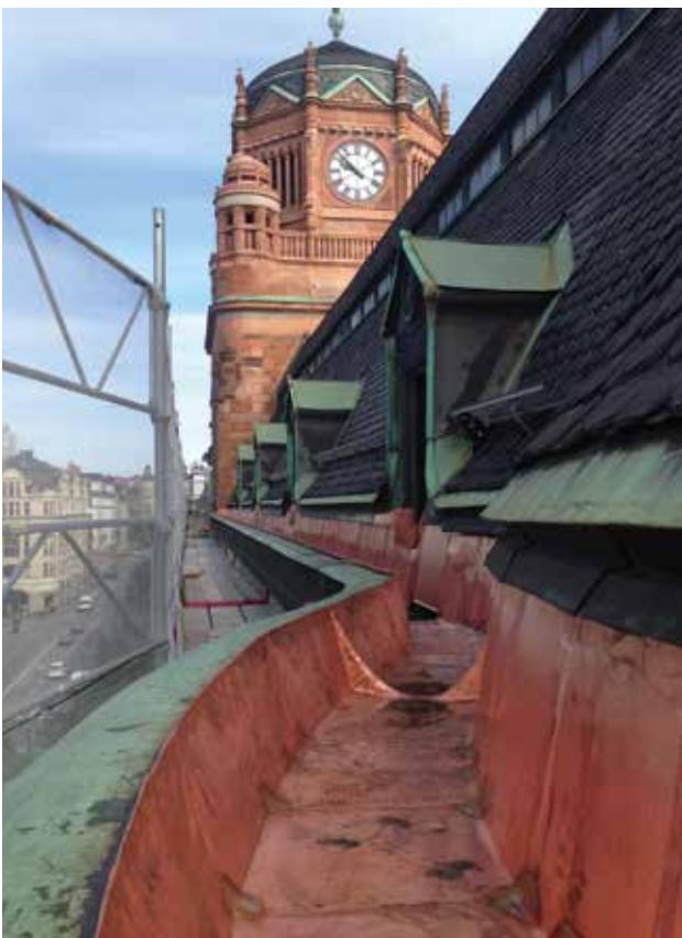
Renoverad gesimsränna med ny kopparplåt. Här utförd med förstärkt underlagstäckning med EPDM-gummiduk.
