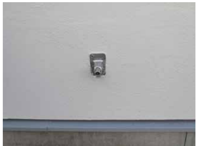
Avsaknad av skyddsbeslag ökar risken för skador i fasaden.
