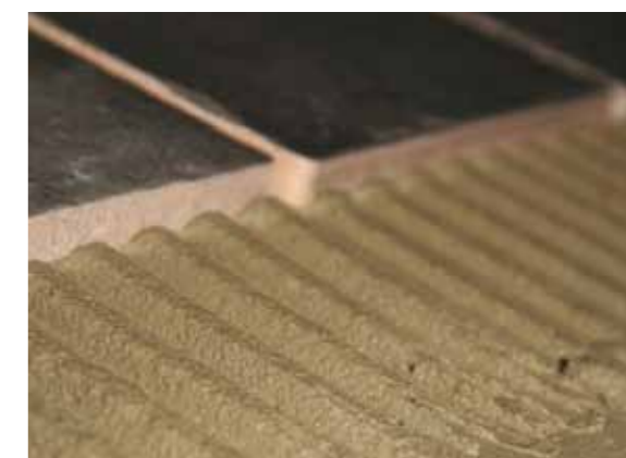
Plattor monteras när tätskiktet torkat. Detta får göras tidigast efter 12 tim, på tätade ytor.
