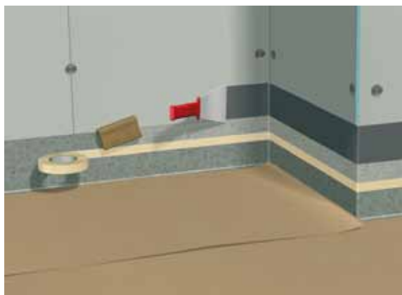
Bild A: Vid behov spacklas kanten mot plastmattan. Mattuppvikets överkant slipas och golvet skyddas mot spill.
